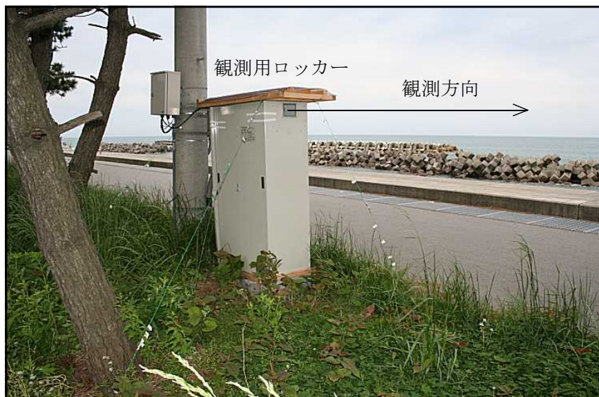
第2図 定点カメラの設置とロッカー内部の様子
